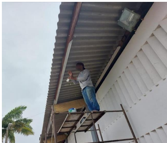
Figura 10 - Colaboradores tabalhando sem a utilização dos EPI's.
