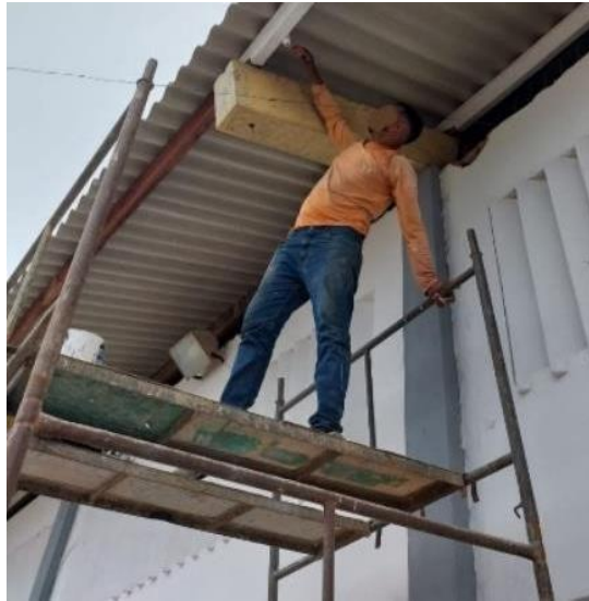
Figura 11 - Colaboradores trabalhando sem os devidos equipamentos de proteção.
