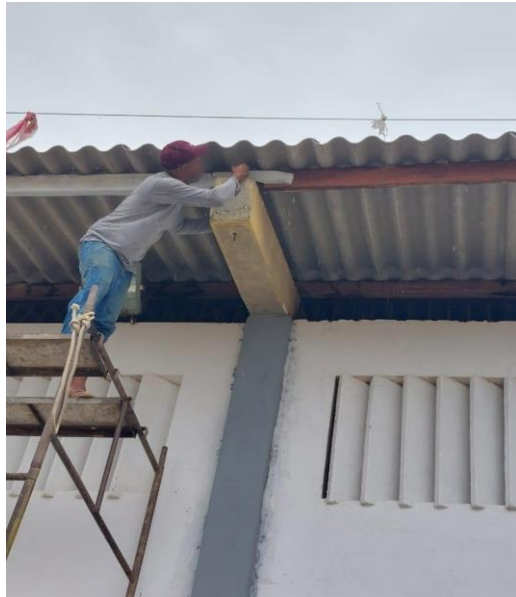
Figura 9 - Colaboradores trabalhando sem os devidos equipamentos de proteção.
