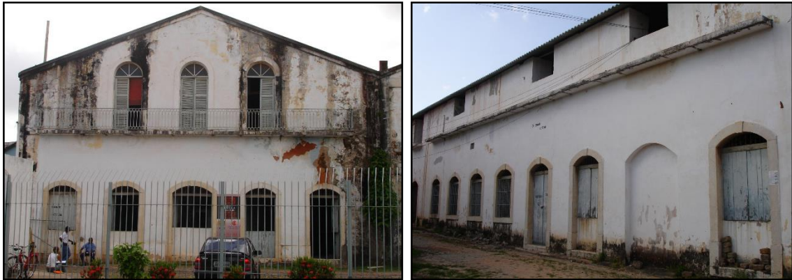
Figura 78 – Aspecto das fachadas principal e lateral do Galpão 3 em 2004, com rebaixamento da cobertura e supressões de vãos.
