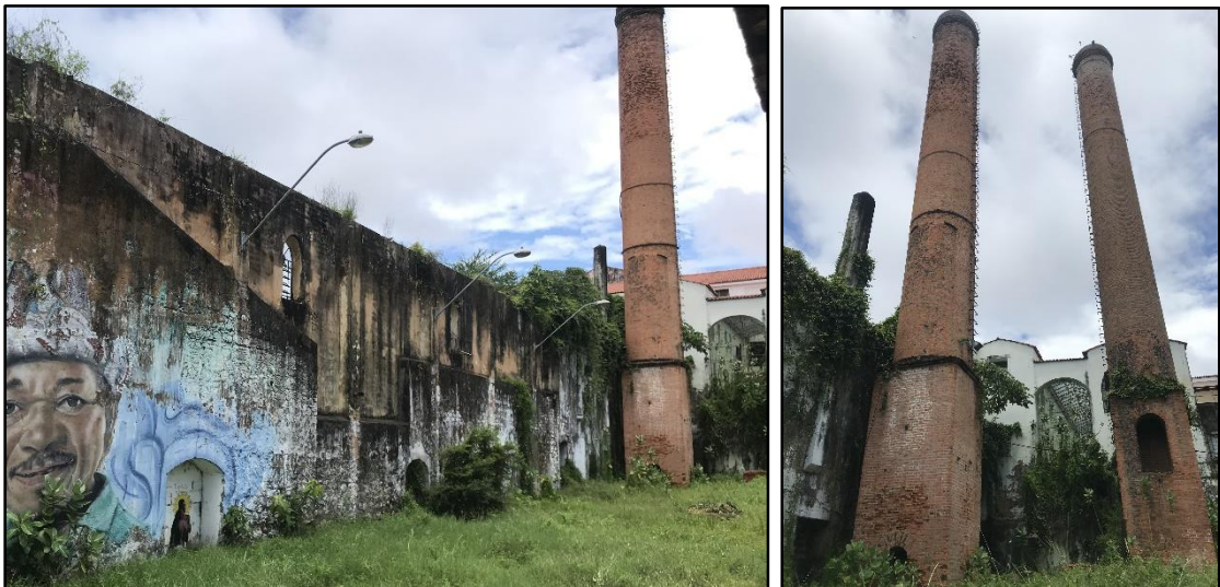
Figura 82 – Trecho posterior da fachada lateral do Galpão 4 e situação das duas chaminés.
