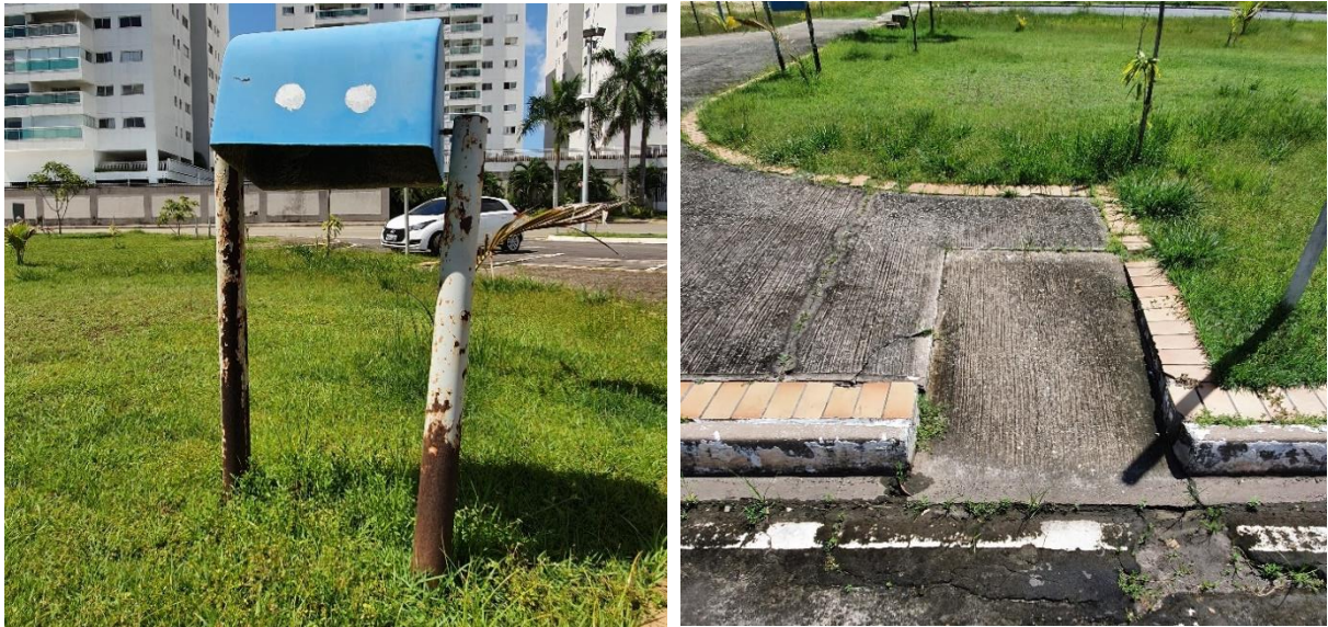
Figura 45 - Lixeira inadequada e tentativa de acessibilidade.
