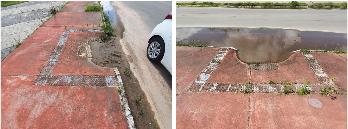
Figura 75 - Rebaixamento na calçada.
