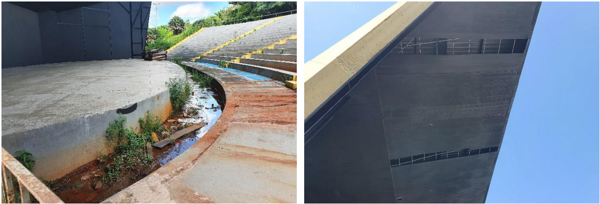
Figura 47 - Problemas encontrados na concha acústica.
