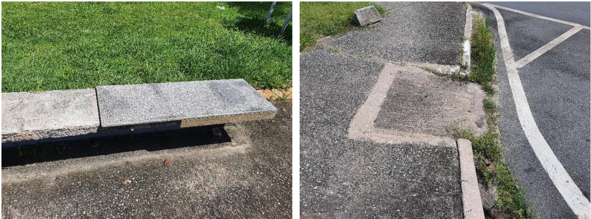
Figura 35 - Banco deteriorado e rebaixamento na calçada.
