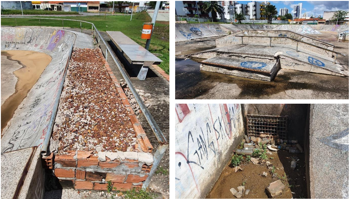
Figura 37 - Pista de skate deteriorada.
