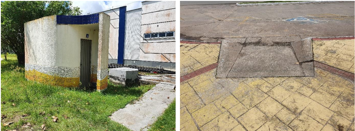
Figura 64 - Problemas de acessibilidade.
