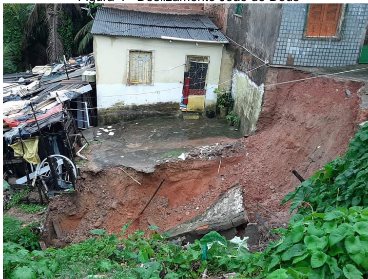
Figura 4 - Deslizamento João de Deus
