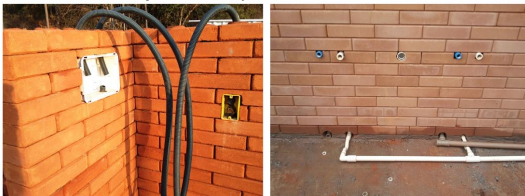
Figura 34 - Instalações elétricas e hidráulicas
