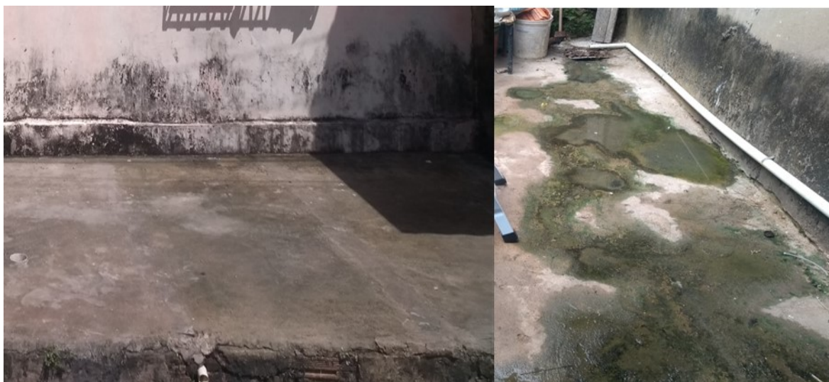
Figura 15 – Manchas por umidade
