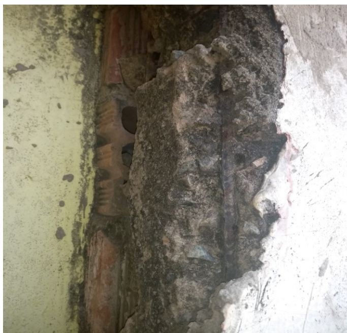
Figura 17 – Desagregação do concreto do pilar de canto
