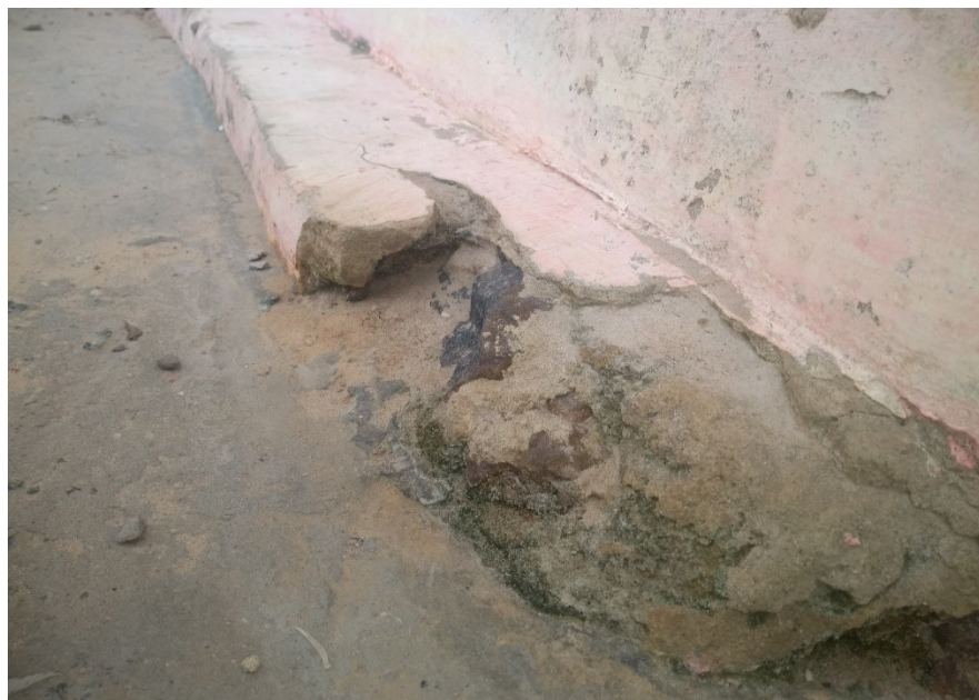
Figura 18 –Desagregação do reboco na base da fachada
