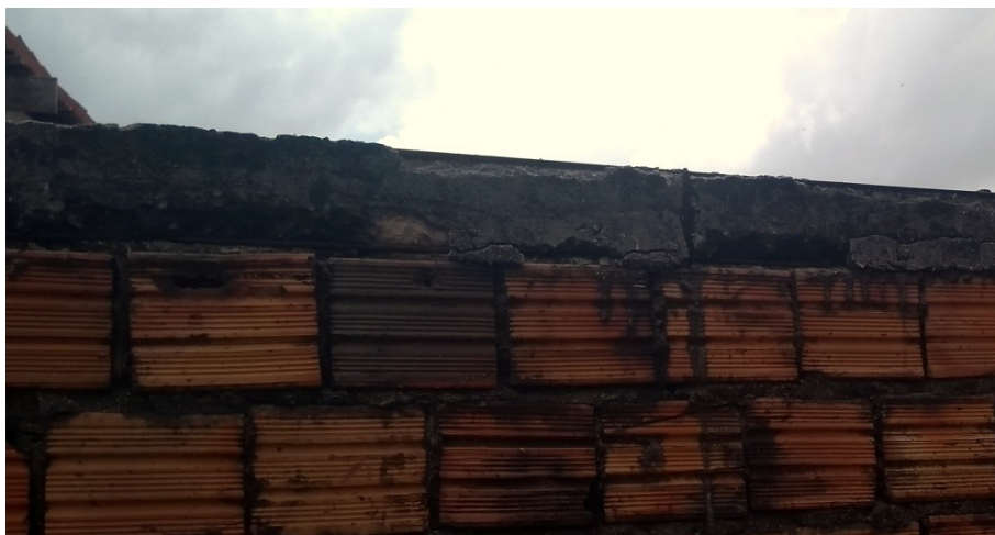
Figura 16 – Desagregação do concreto da cinta do muro
