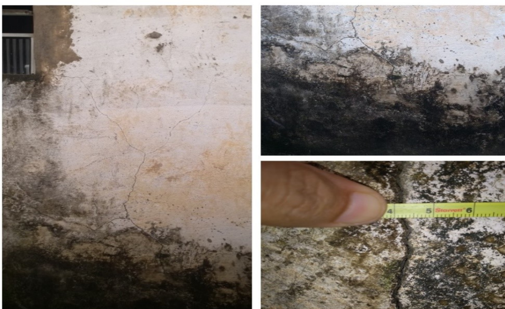
Figura 12 – Fissuras mapeadas, bolo/mofo
