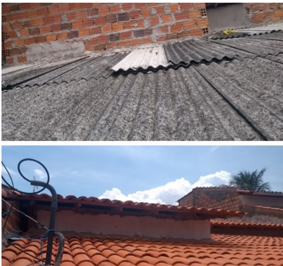
Figura 22 – Telhado sem rufos
