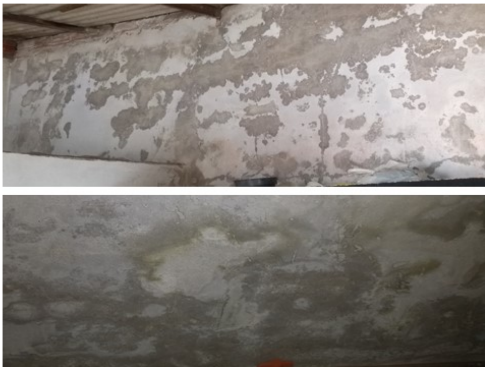
Figura 19 - Manchas proveniente de umidade
