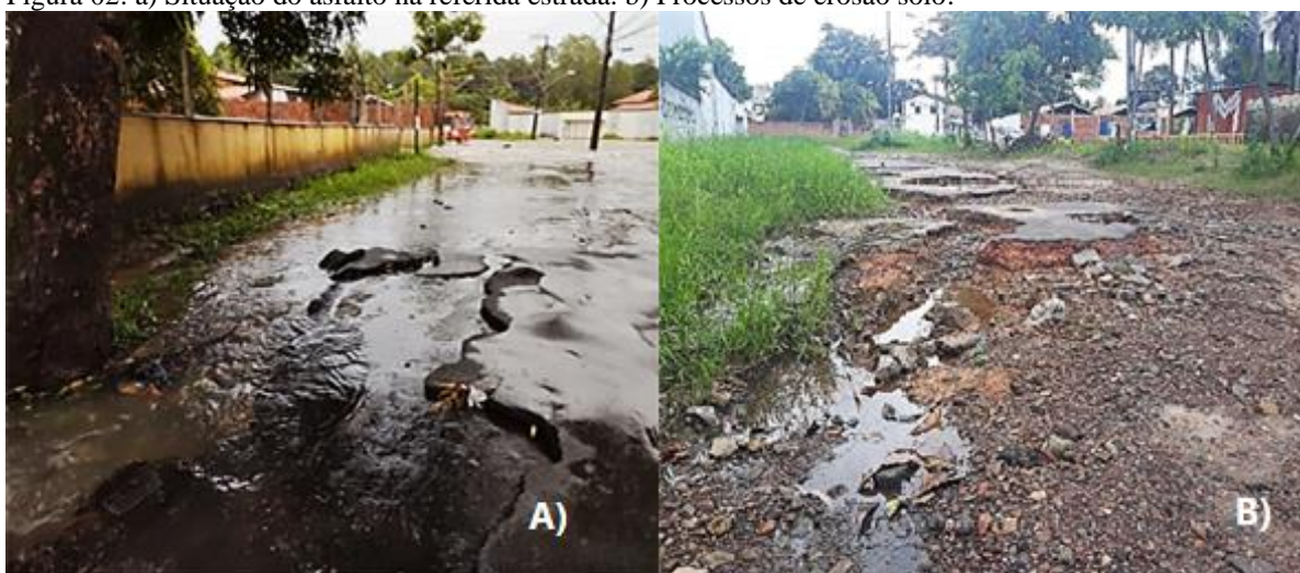
Figura 02: a) Situação do asfalto na referida estrada. b) Processos de erosão solo.
