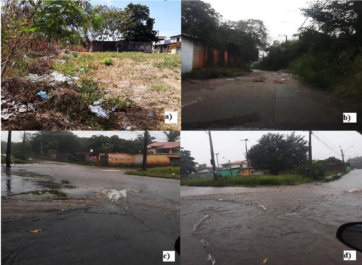
Figura 20: a) Descarte irregular de lixo urbano em terreno baldio. b) Alagamentos com araste de resíduos na faixa de rolamento da via. c) Alagamentos no PE. d) Alagamentos no cruzamento do PE.
