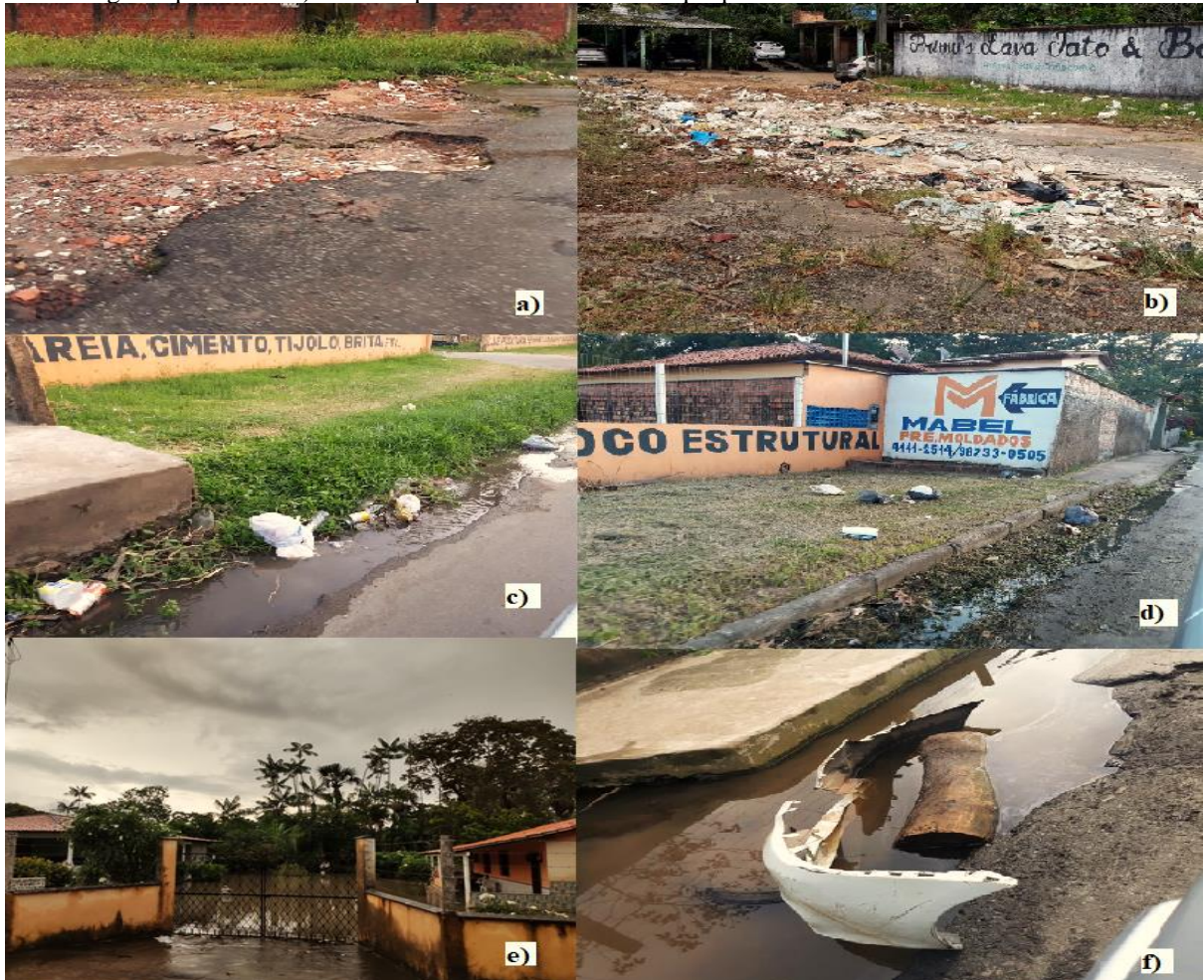
Figura 18: a) Arraste de sedimentos nas vias pavimentadas. b) Resíduos sólidos sendo descartados na rua adjacente a Estrada. c) Lixo descartado no curso da Estrada. d) Lixo descartado indevidamente. e) Casa localizada no PE alagada após chuva. f) Defeitos provocados em veículos que passam no local devido buracos na Estrada.
