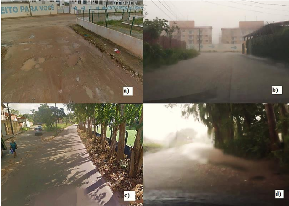
Figura 21: a) Interseção entre a Rua Duque de Caxias e Rua Barão de Itapary, apresentando problemas devido falhas no sistema de drenagem. b) Alagamentos na Rua Barão de Itapary que desaguam nos demais PEs. c) Ausência de dispositivos de microdrenagem e acúmulo de resíduos sólidos frente Associação Do Altos Do Calhau. d) Alagamentos frente a Associação Do Altos Do Calhau.
