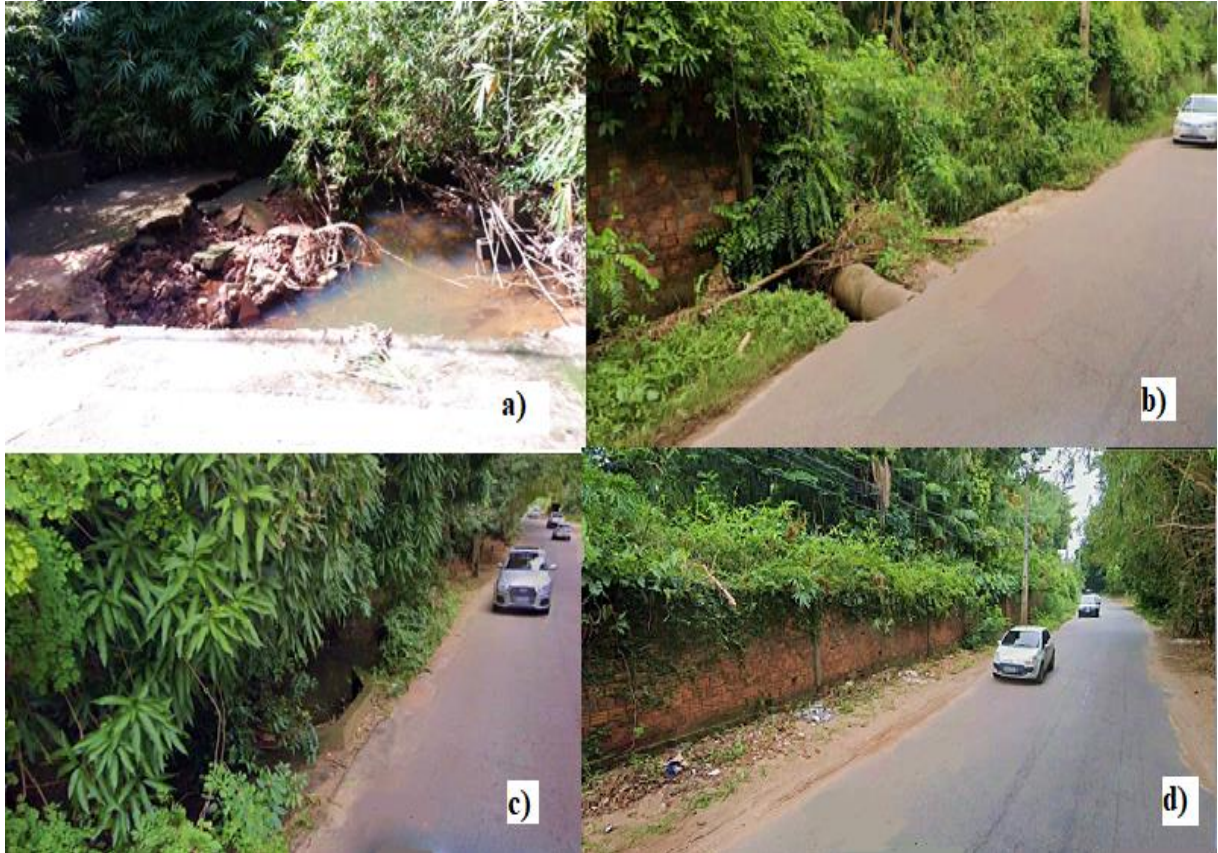
Figura 14: a) Afluente na Estrada do Pimenta, vista mais a jusante. b) Afluente na Estrada do Pimenta coberto pela vegetação, vista mais a jusante. c) Afluente na Estrada do Pimenta, vista mais a montante. d) Ausência de dispositivos de microdrenagem e descarte irregular de resíduos.
