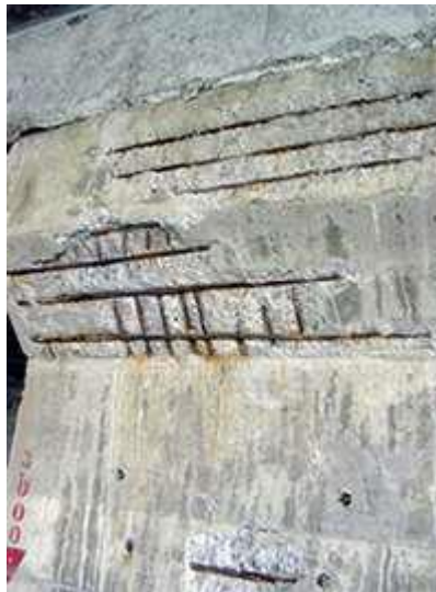
Figura 1: Corrosão da armadura no concreto.
