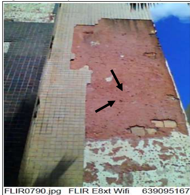
Figura 39 - Condições de assentamento da placa cerâmica.
