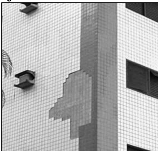
Figura 7 – Destacamento cerâmico em revestimento de fachada.
