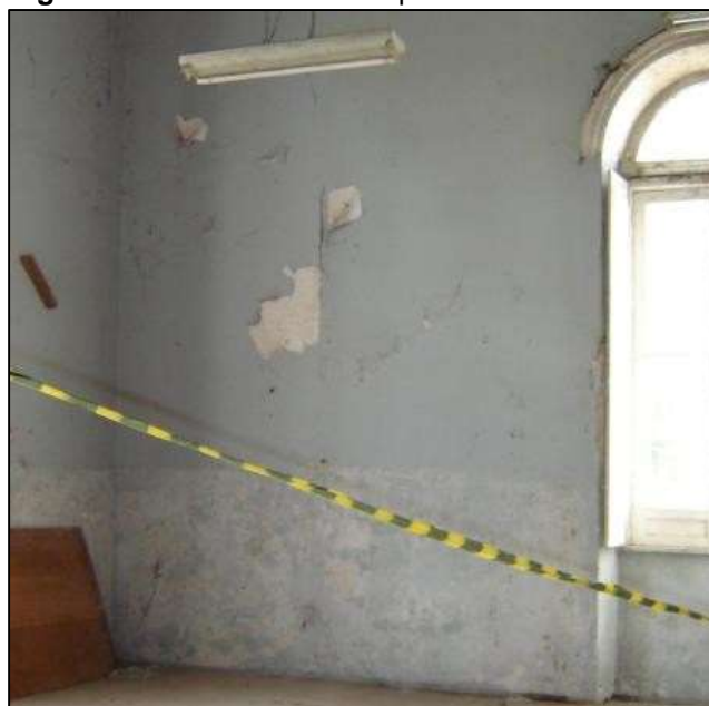
Figura 6 – Descolamento da pintura.
