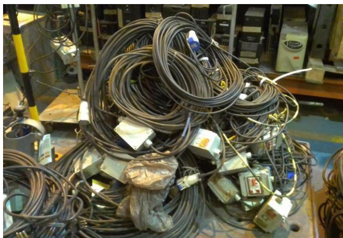
Imagem 02 – Material sem utilização ocupando espaço físico.
