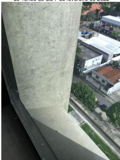
Figura 8: Brises da fachada sul-sudoeste em seu correto desempenho da proteção solar direta, às 15h36 do dia 7 de fevereiro de 2022
