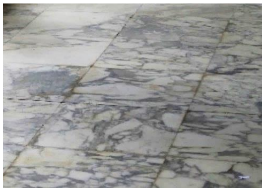
Figura 10: Mármore do piso do foyer principal, com alterações cromáticas.
