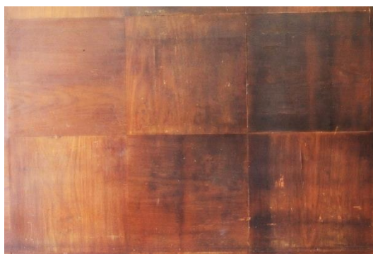
Figura 11: Lambri do foyer superior, com fissuras e alterações cromáticas.
