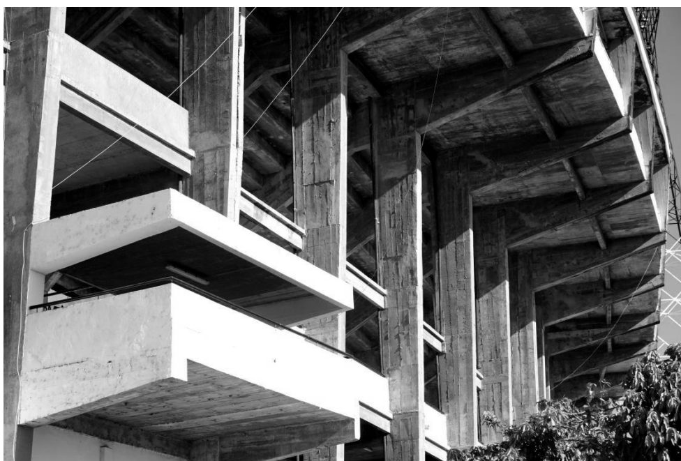
Figura 21: Vista do sistema estrutural que suporta as arquibancadas superiores. Foto dos autores, 2017.
