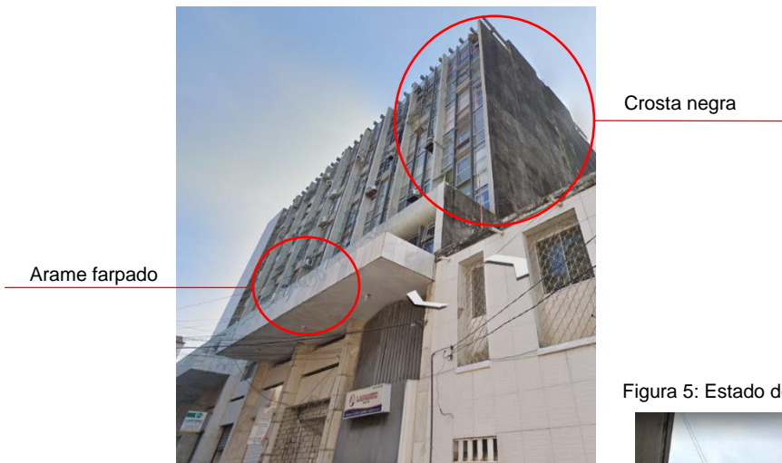
Figura 4: Estado de conservação das fachadas Leste e Norte
