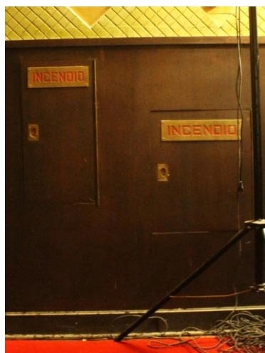
Figura 9: Armários para instalações de incêndio na sala de espetáculos.
