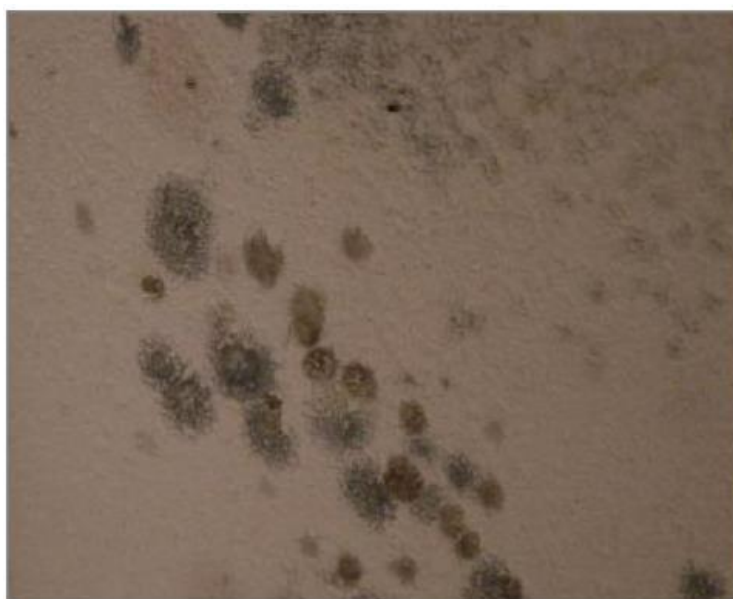
Figura 5 – Umidade por condensação
