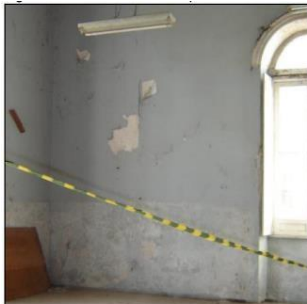
Figura 9 – Descolamento da pintura
