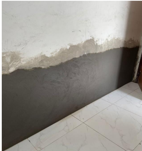
Figura 26 – Parede rebocada com aditivo impermeabilizante
