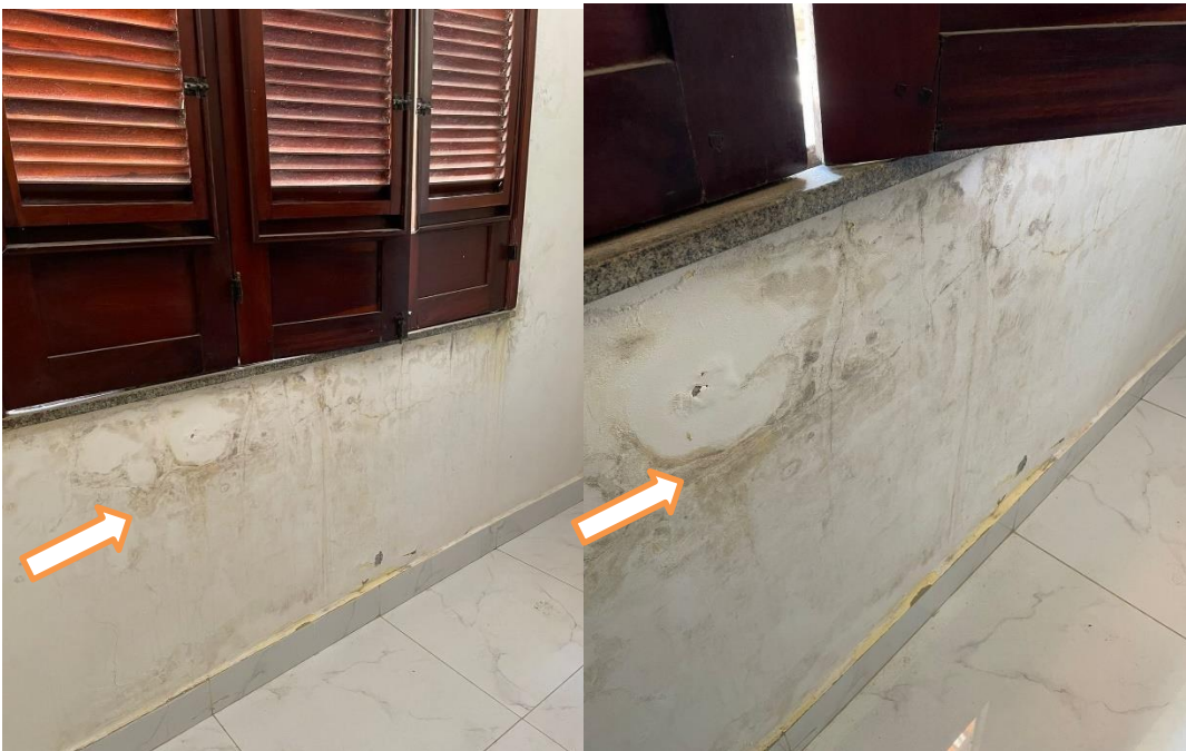
Figura 18 – Manchas na parede por umidade ascendente
