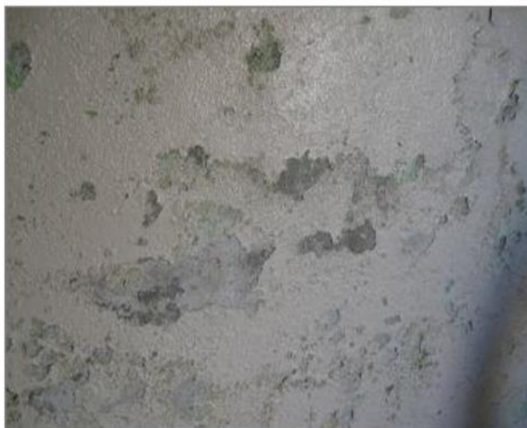
Figura 2 – Umidade por infiltração
