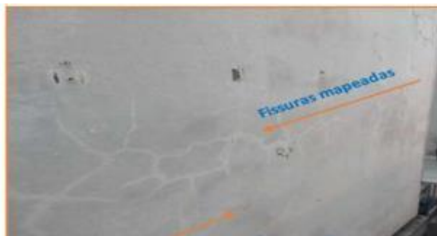
Figura 6 - Fissura por mapeamento.
