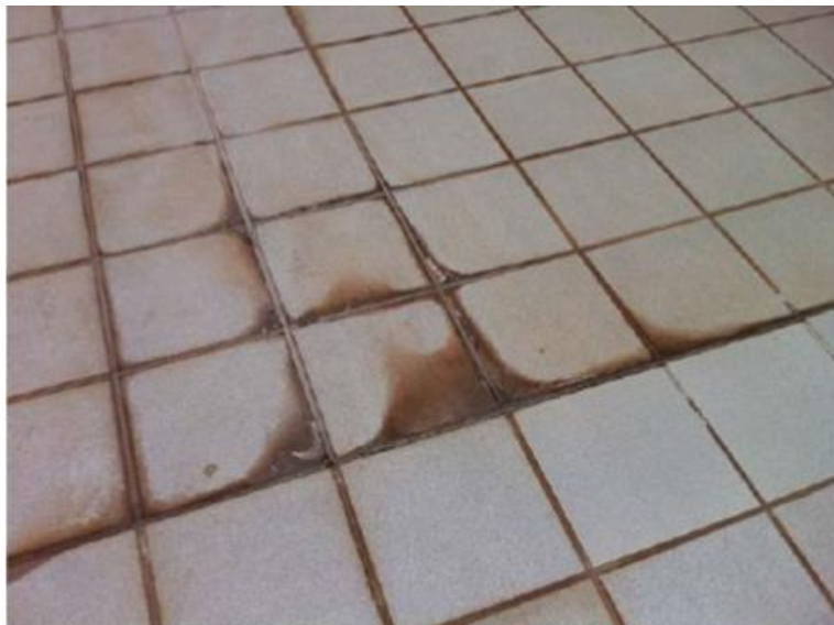
Figura 10 - Eflorescência em piso cerâmico.
