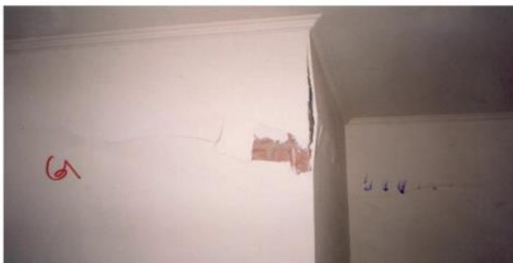
Figura 7 – fissuras por movimentação higroscópica
