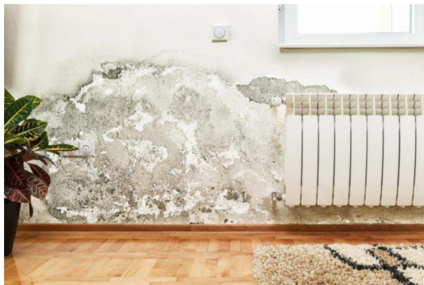
Figura 4 – Umidade por capilaridade com manchas na parede
