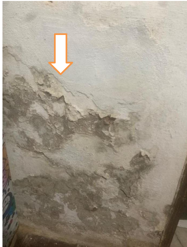
Figura 19 – presença de manchas e fungos
