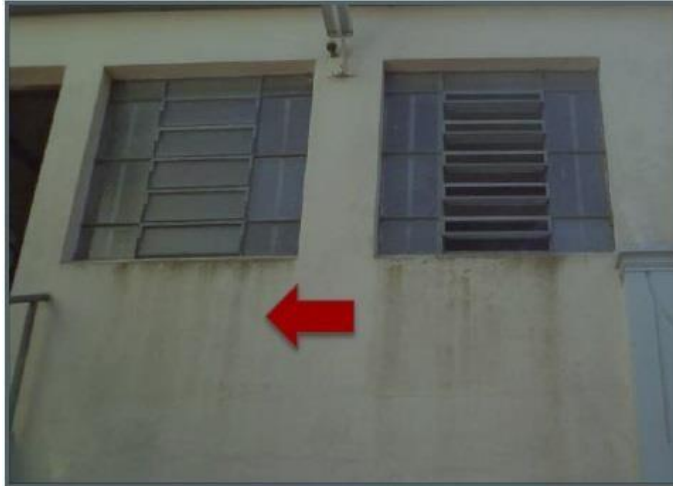
Figura 8 - Manchamento por sujeira.
