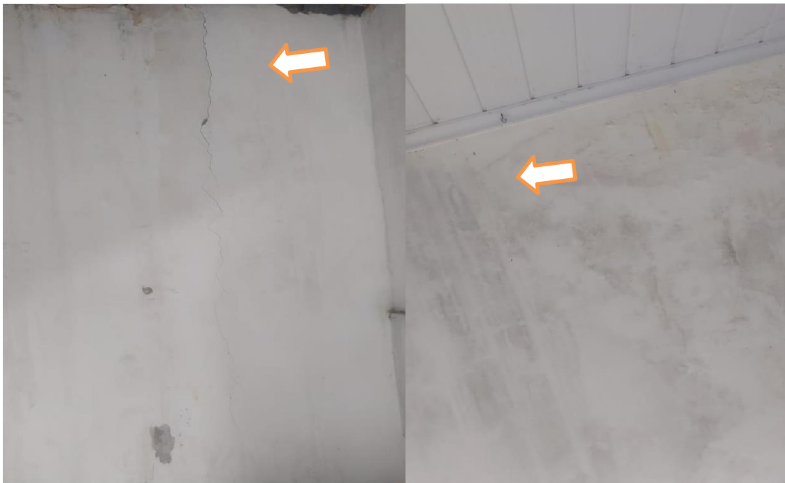
Figura 20 – Trinca e manchamento superior
