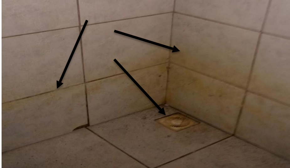
Figura 21- Eflorescência no revestimento cerâmico do banheiro.
