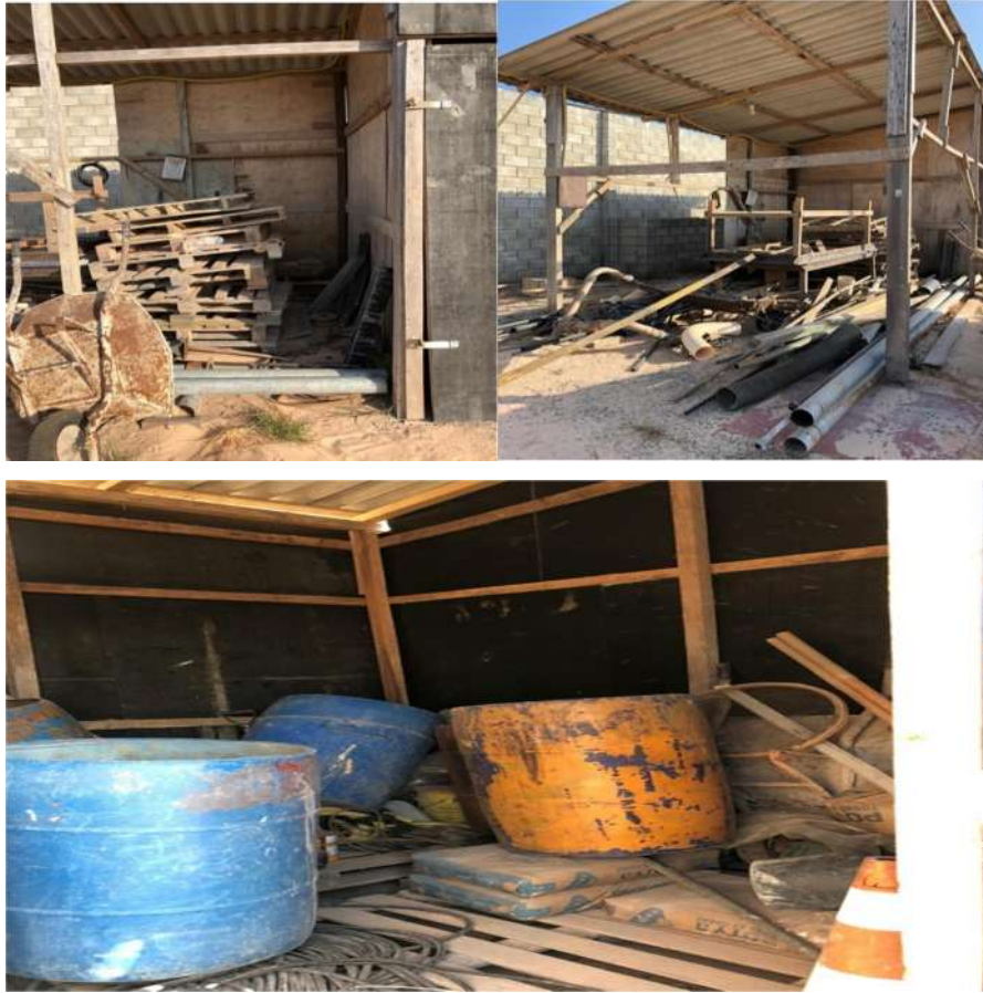
Figura 16 - Desperdício de materiais no canteiro de obras
