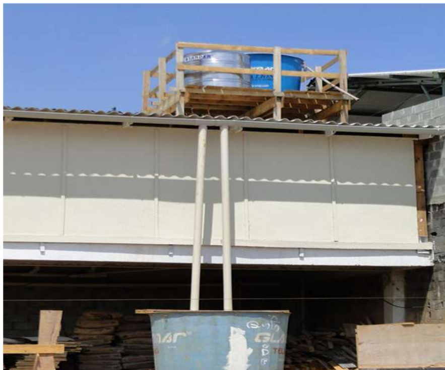
Figura 21 - Sistema de captação de água de telhado
