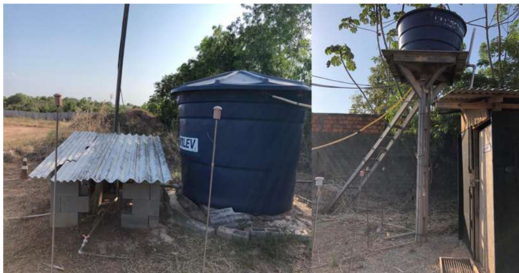
Figura 12 - Captação e armazenamento de água
