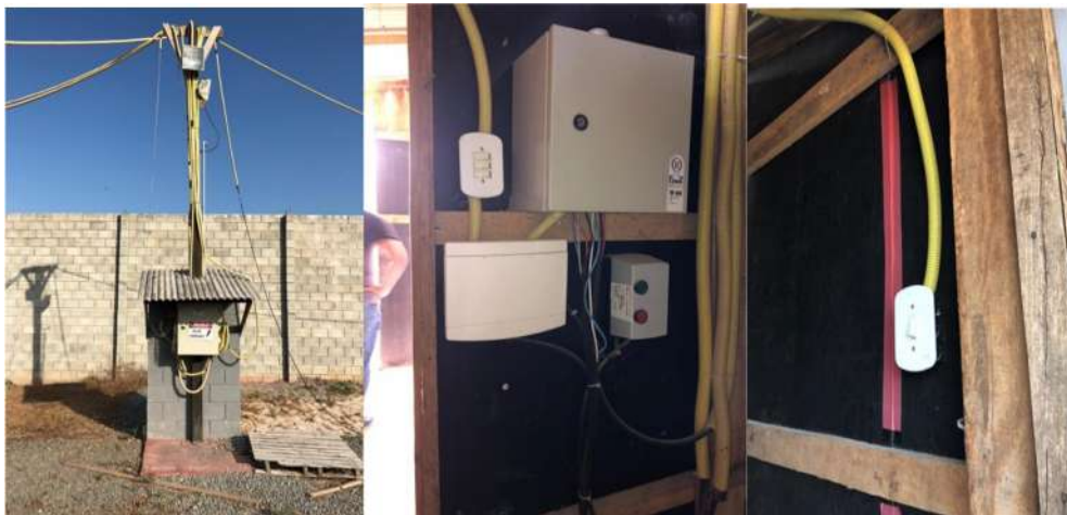
Figura 17 - Quadro de distribuição e energia e instalações provisórias
