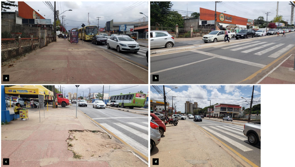
Figura 75 – Faixa de Travessia de Pedestres.
