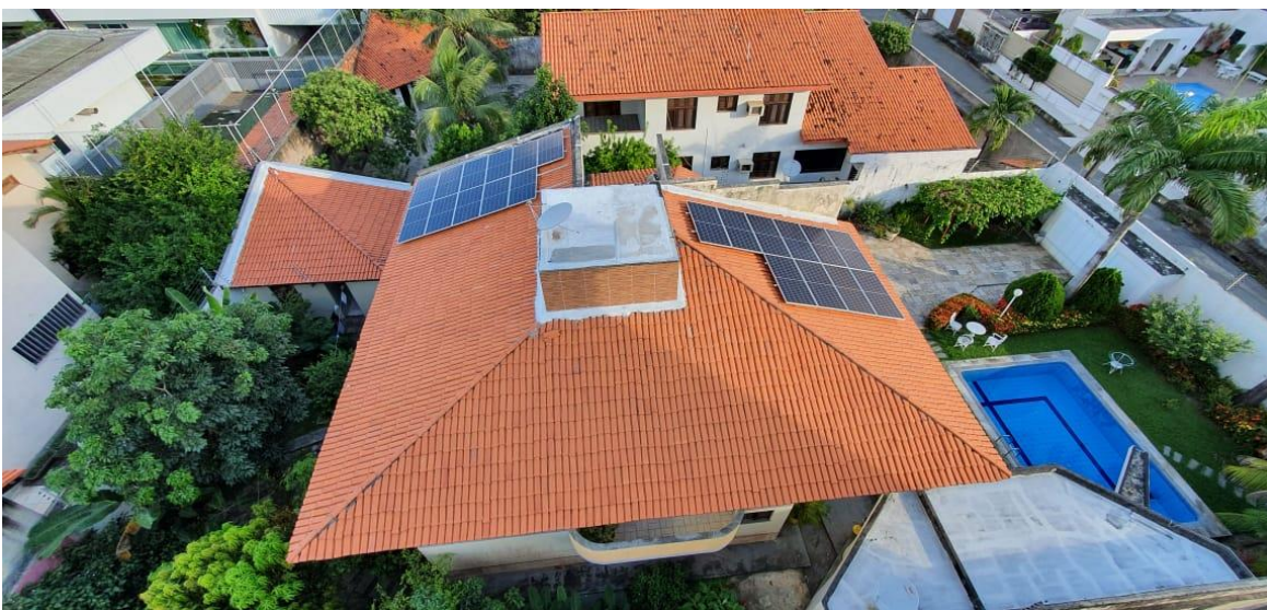
Figura 24 - Vista das placas fotovoltaicas no telhado da casa
