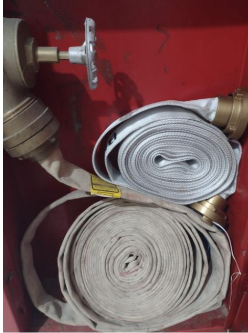
Figura 45 - Mangueira enrolada e boca de incêndio
