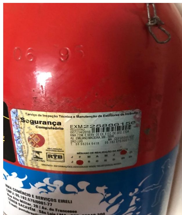
Figura 19 - Prazo de manutenção dos extintores
