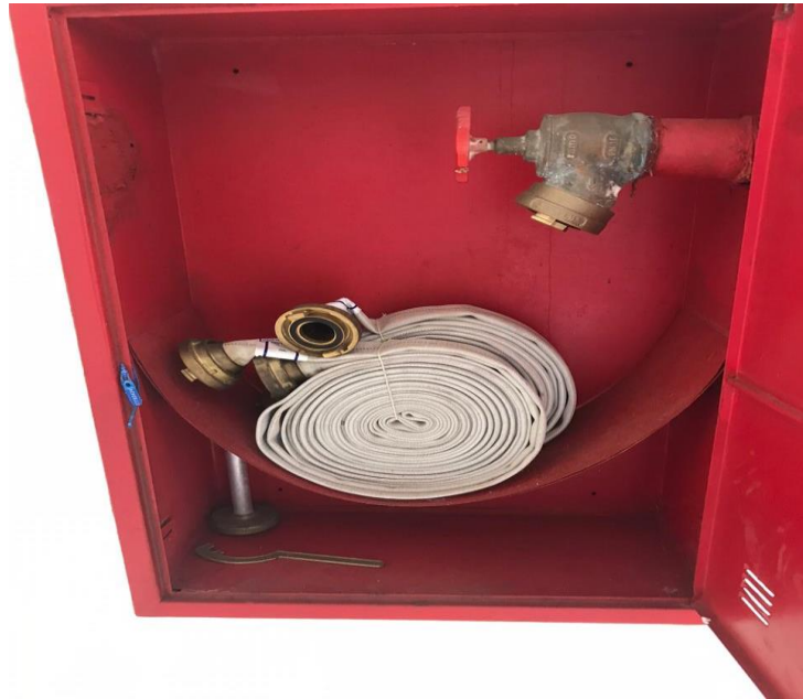
Figura 65 - mangueira do sistema de hidrante
