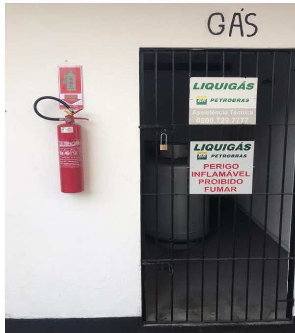
Figura 48 - Extintor próximo da central de gás
