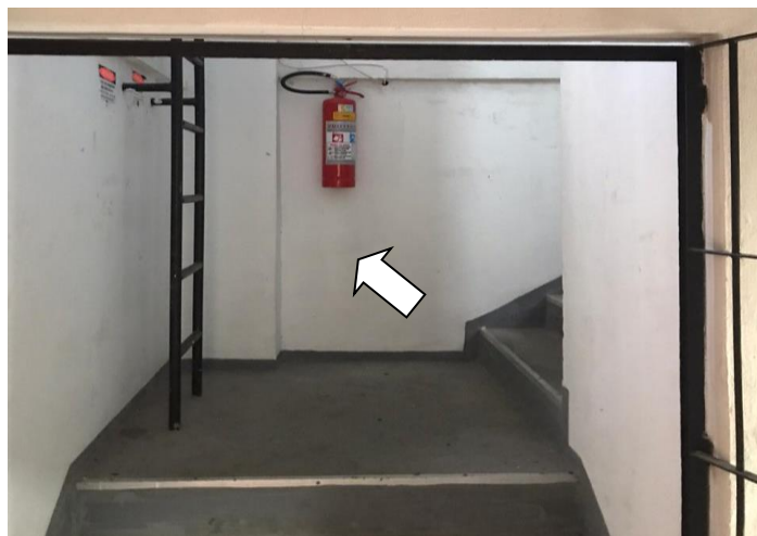
Figura 34 - Altura dos extintores em cada pavimento
