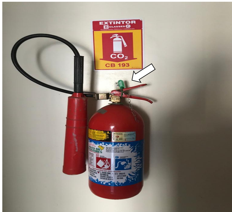
Figura 20 - Extintores com lacre preservado
