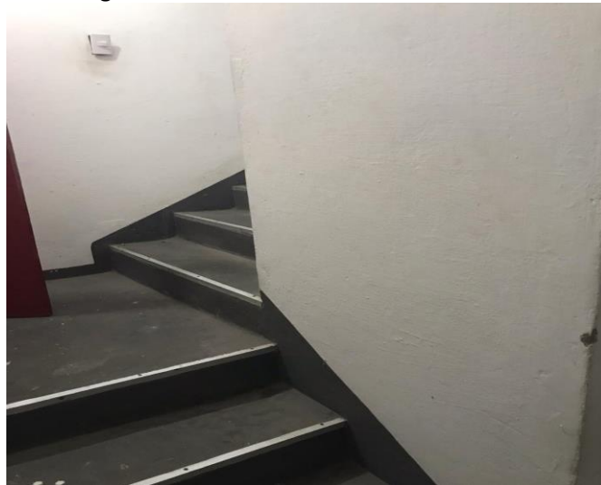
Figura 43 - Ausência de corrimão nas escadas
