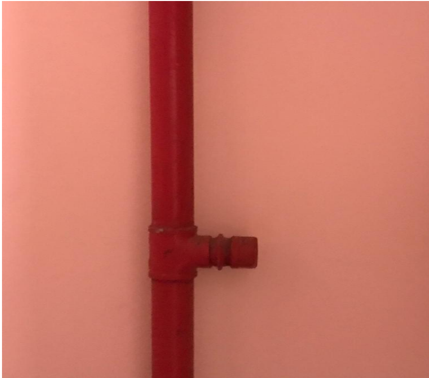
Figura 30 - Coluna sem a presença da caixa de hidrante (2º pavimento)
