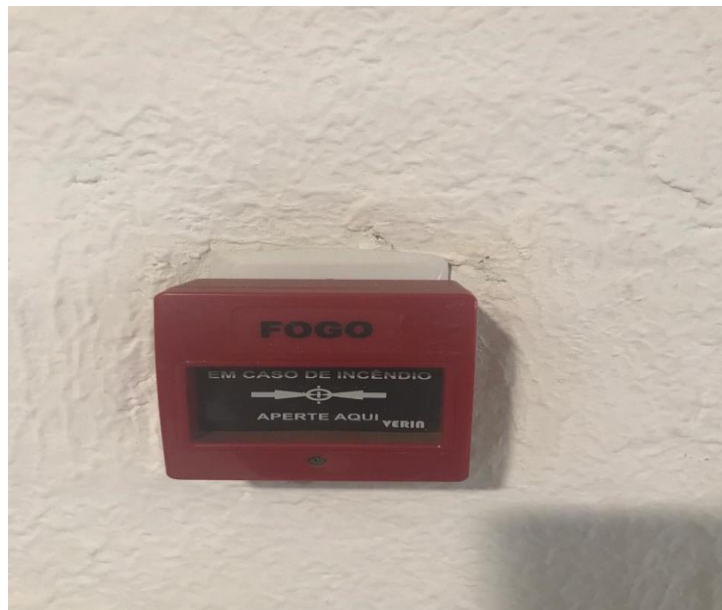
Figura 63 - Alarme de incêndio
