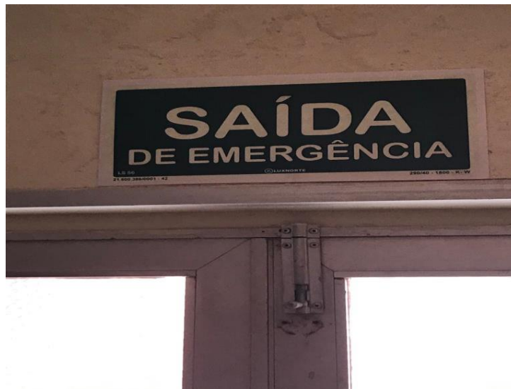
Figura 24 - Sinalização de orientação e salvamento ( Saída de emergência )
