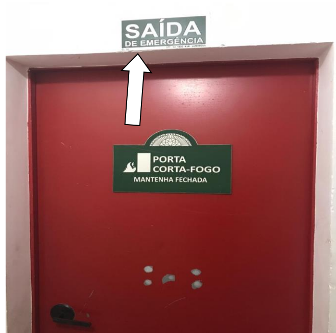
Figura 54 - Placa de saída de emergência
