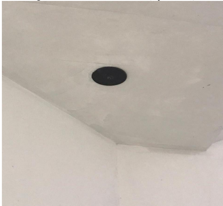
Figura 42 - Ausência de luminária (2º pavimento)
