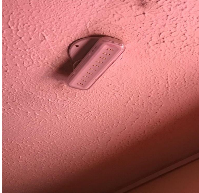
Figura 21 - Luminária fluorescente com defeito e localizada no teto
