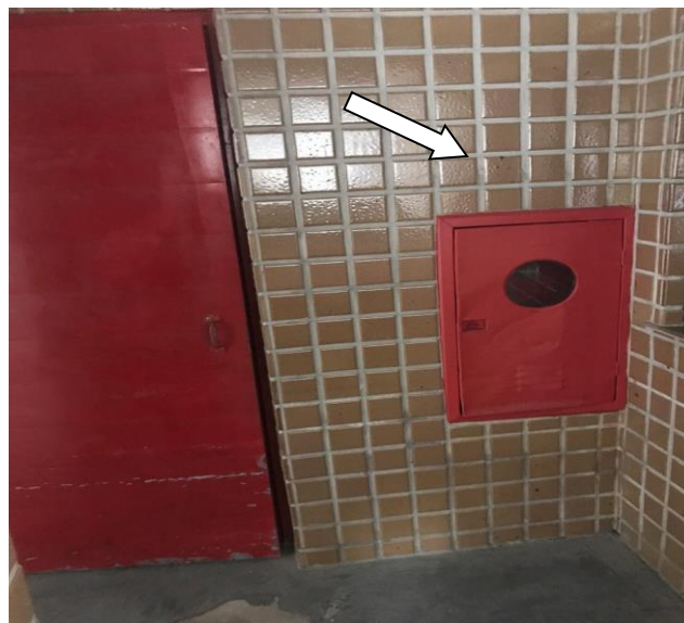
Figura 39 - Falta de sinalização do hidrante
