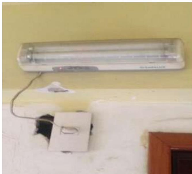
Figura 22 - Erros na instalação da luminária
