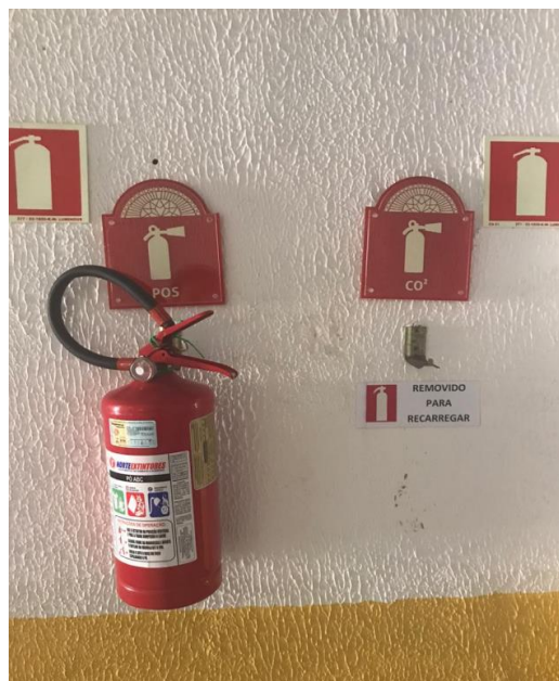
Figura 55 - Placa do equipamento extintor
