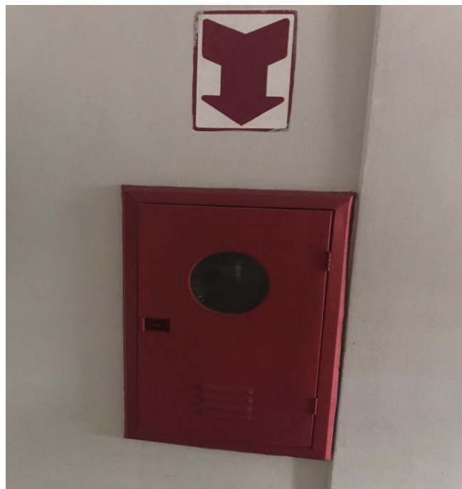
Figura 46 - Ausência de sinalização adequada do hidrante
