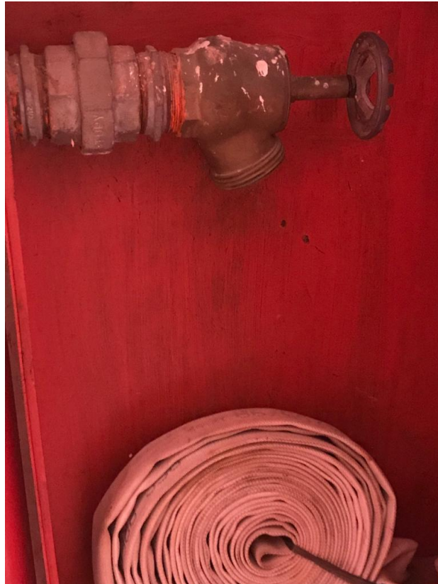
Figura 27 - Mangueira e boca de incêndio
