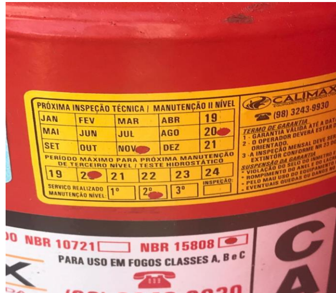
Figura 52 - Manutenção do extintor no edifício Provença
