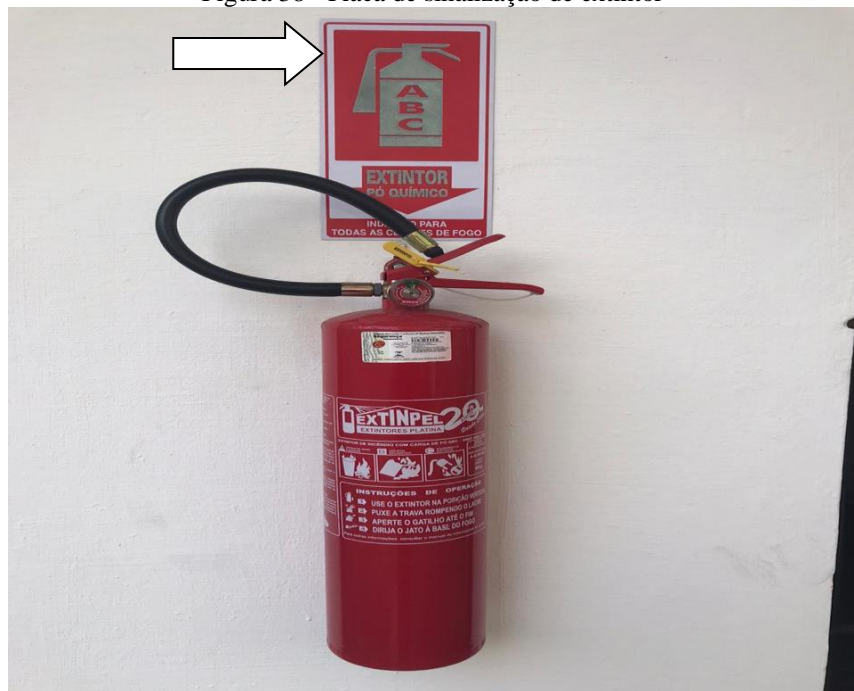
Figura 38 - Placa de sinalização de extintor
