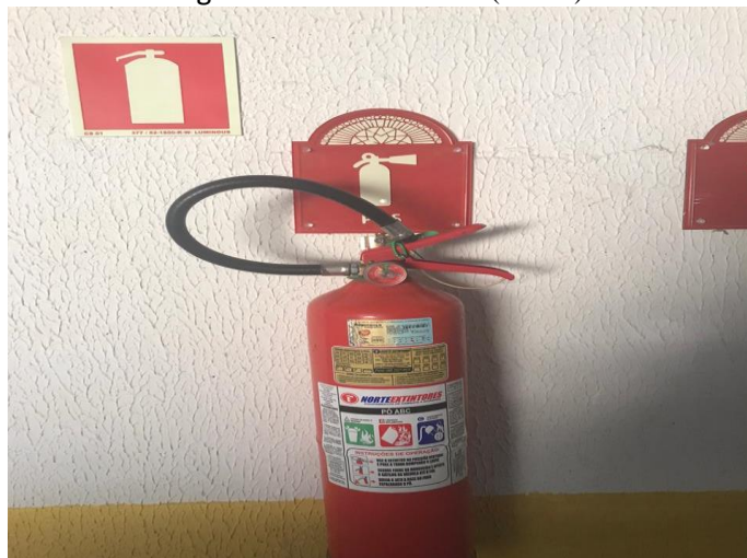
Figura 50 - Extintor ABC ( térreo)
