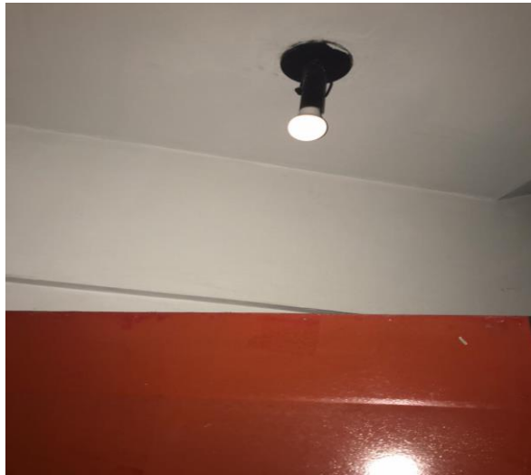
Figura 41 - Local das luminárias
