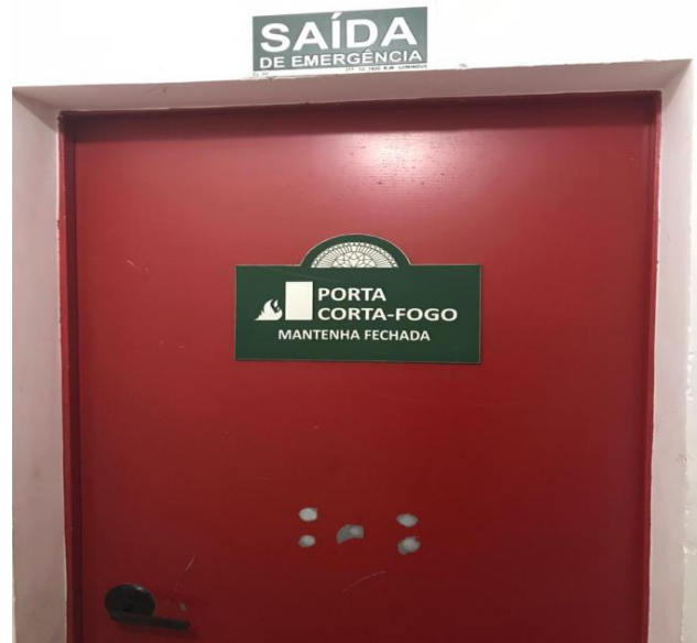
Figura 62 - Porta corta fogo
