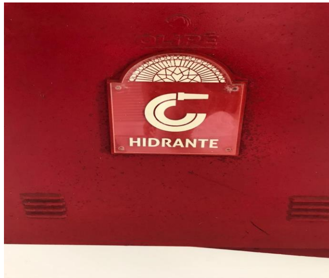
Figura 56 - Placa do equipamento hidrante
