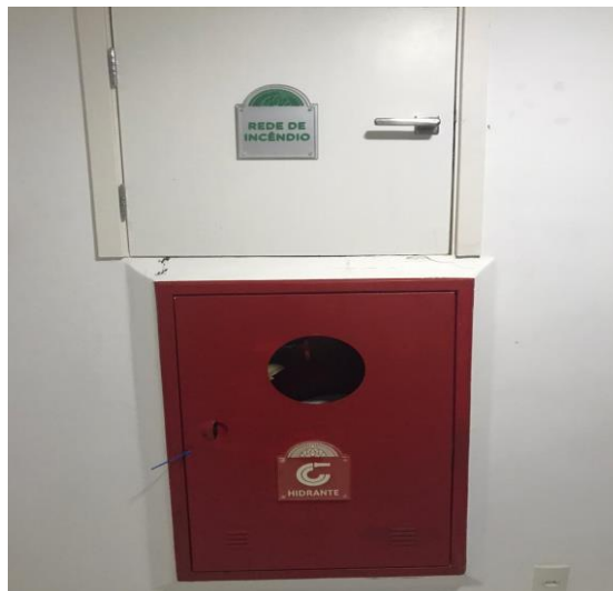
Figura 64 - Hidrante em cada andar do edifício
