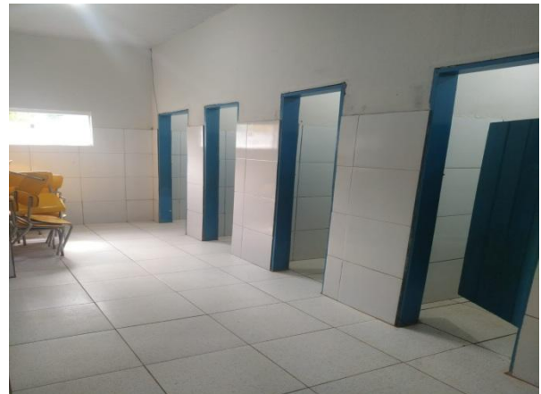
Figura 40 – Obstáculos no banheiro feminino
