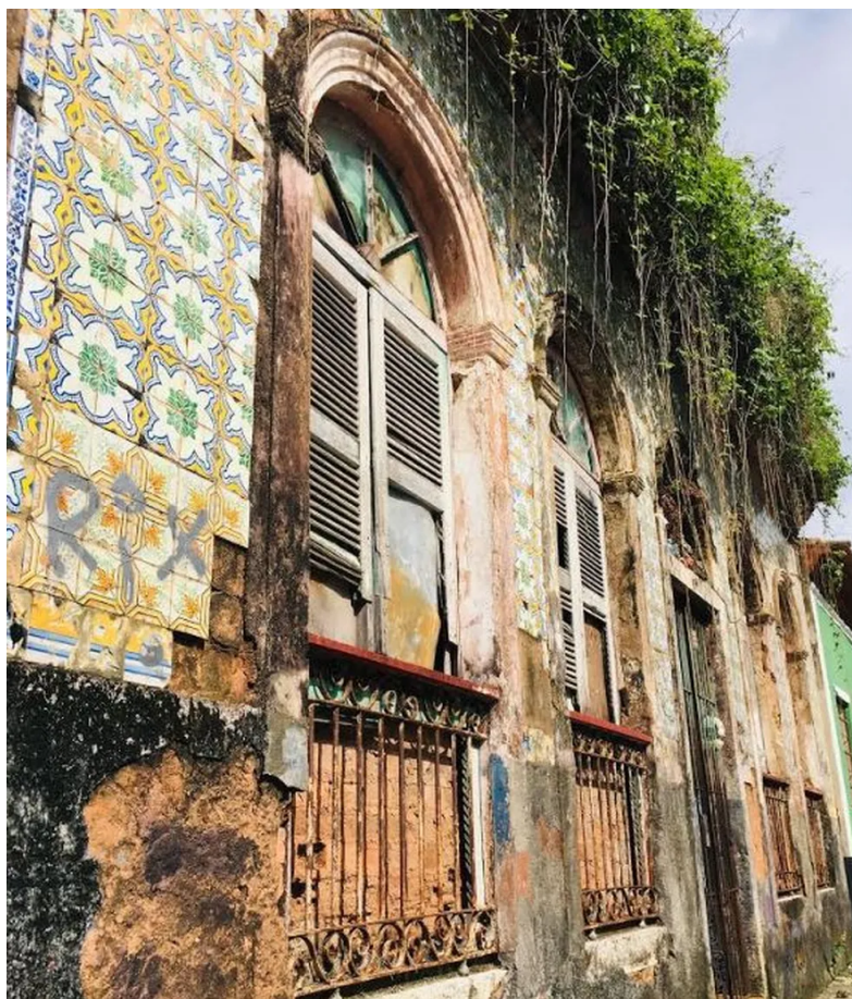
Figura 9 - Edifício em estado de degradação no Centro (2022)
