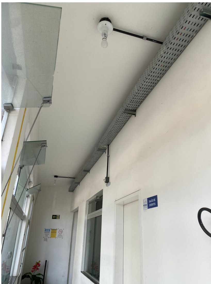
Figura 31 - Instalação Elétrica nas áreas comuns.
