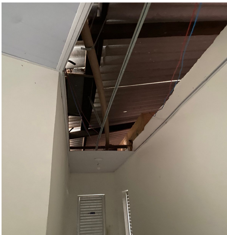
Figura 34 - Estado do Forro de PVC no hall do último pavimento
